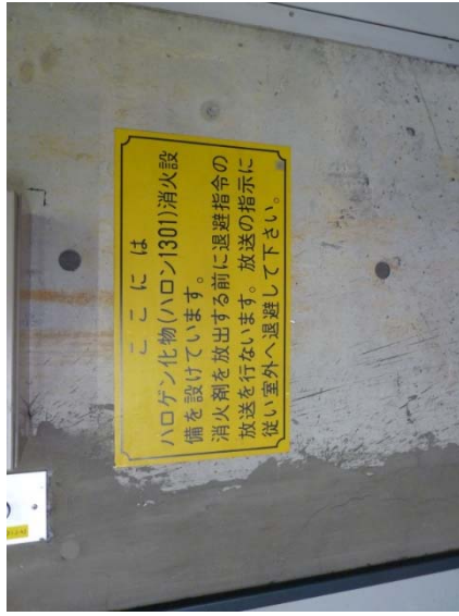
消火設備の告知看板
