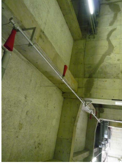
配管と放出口
